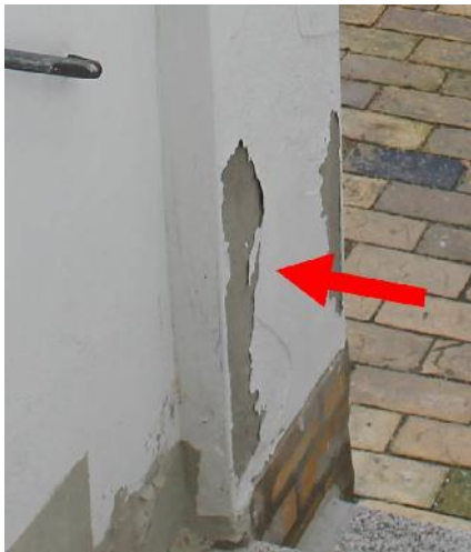
abgelöste Farbschicht am Hauseingang
