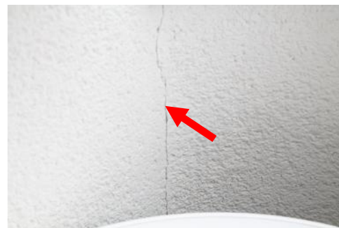
Riss im Putz der Balkonmuer (WE Nr. 13)
