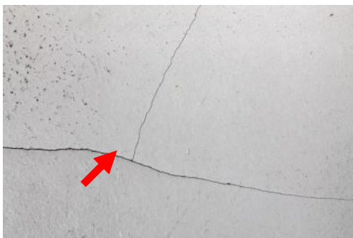
Risse im Balkonfußboden (WE Nr. 13)
