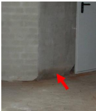
Feuchtigkeitsflecken im Keller
